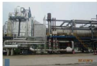
天然气净化装置-尾气余锅-四川普光气田
