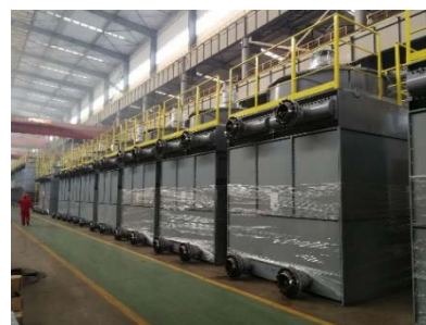
浙江石化一期项目
