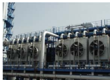
兰炼 500 万吨/年常减压装置减顶板式空冷器
