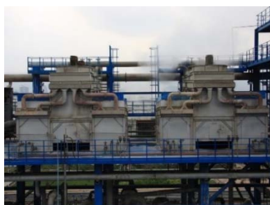
兰州石化 500 万吨/年常减压装置初顶空冷
