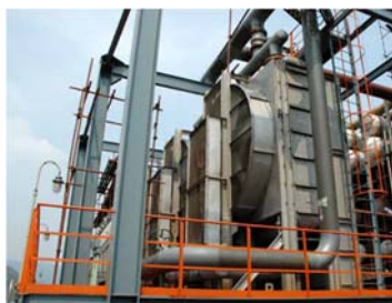
燕山 70 万吨/年糠醛抽提塔顶板式空冷器
